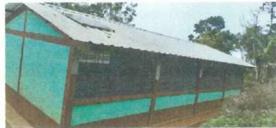
Foto 2: Se observa que el techo de los dos módulos del centro educativo se encuentra en mal estado, presentando deterioro que puede comprometer su funcionalidad y seguridad.
