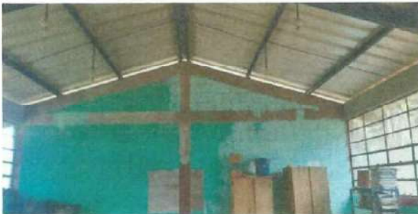
Foto 3: Se observa que la pintura en el interior de los módulos del centro educativo se encuentra en mal estado, presentando desgaste, decoloración y desprendimientos.
