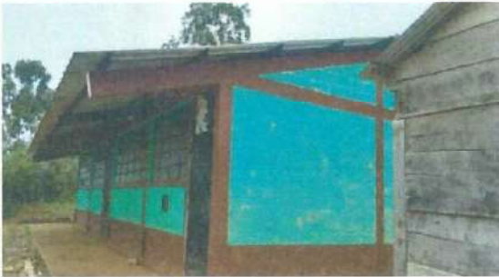
Foto 1: Se observa desprendimiento en la estructura portante de las paredes, lo que evidencia un deterioro significativo que podría afectar la estabilidad y seguridad del centro educativo.
